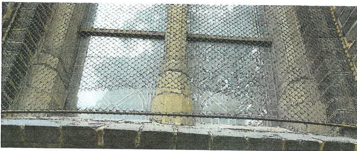
Przykład rozerwanej i skorodowanej siatki.
