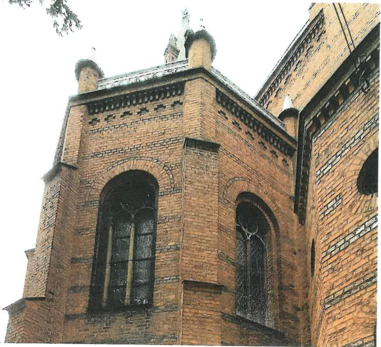
Okna i witraże w prezbiterium, po lewej widoczne zniszczone zabezpieczenia okna siatką.
