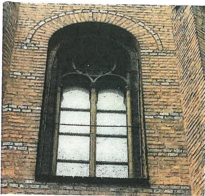
Okno nr 3 w prezbiterium, widoczna korodująca siatka.
